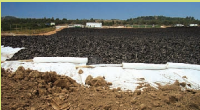
Varios momentos de la construcción de la capa de drenaje de aguas superficiales del antiguo vertedero de L'Aldea.
